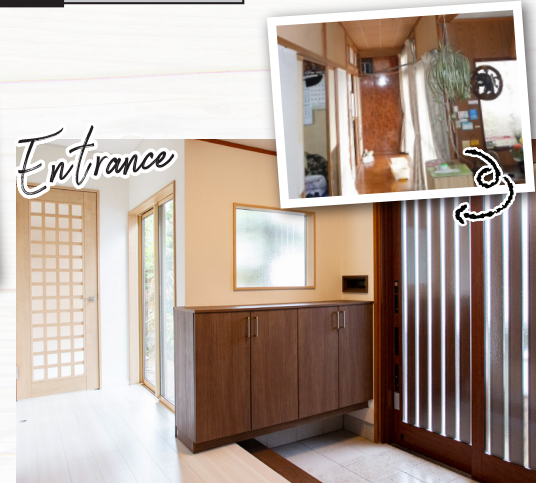
Entrance 玄関から冷気が入り、寒かったホールも断熱性能の高い玄関ドアに入替、内装も新しくして、明るくなりました。
